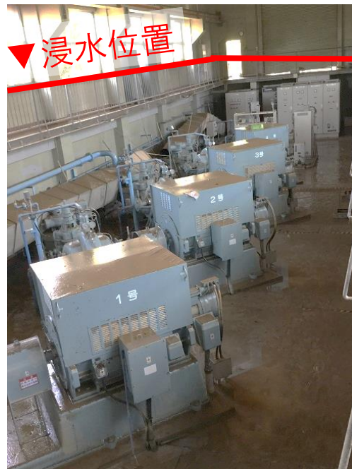
電源喪失 取水ポンプ機能停止
