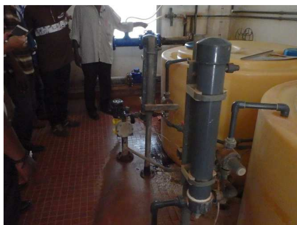
写真-4 塩素消毒設備
