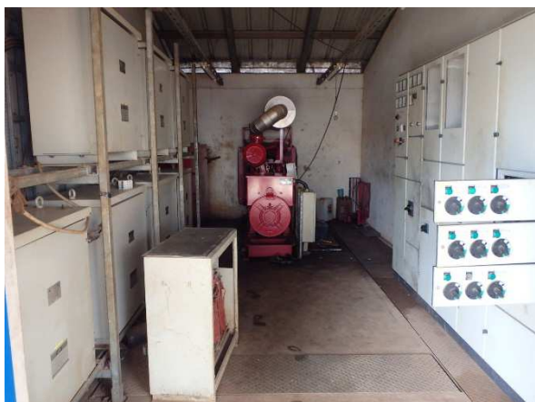
写真-13 ディーゼル発電機、昇圧トランス、 制御盤等
