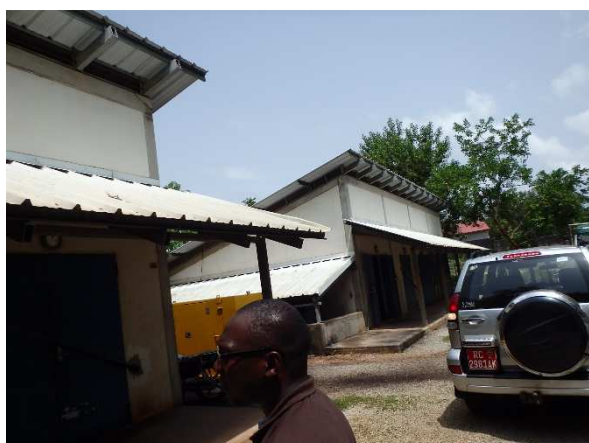
写真-3 浄水処理（中和＋塩素消毒） ディーゼル発電機、受電設備（昇圧トランス含む）
