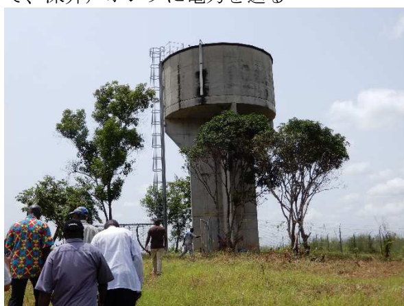
写真-7 150 m 3 の高架水槽 地区内で高い丘の上に建造されている
