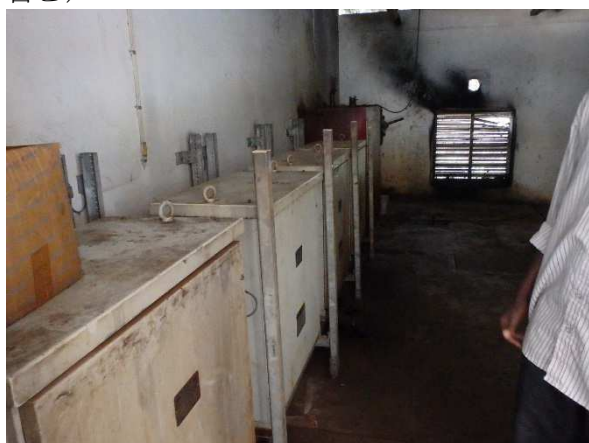
写真-5 昇圧トランス 400V で受電した後に 1,000V にまで昇圧して、深井戸ポンプに電力を送る
