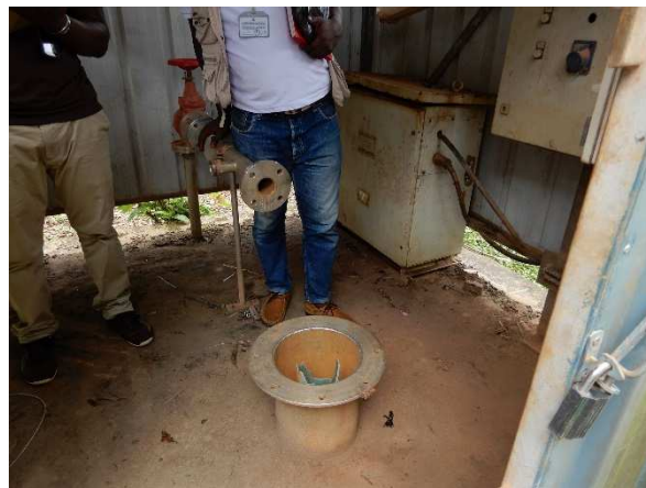
写真-2 深井戸 水中ポンプ落下により休止中
