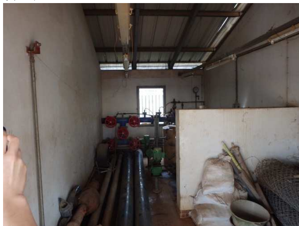
写真-12 故障中の中和装置
