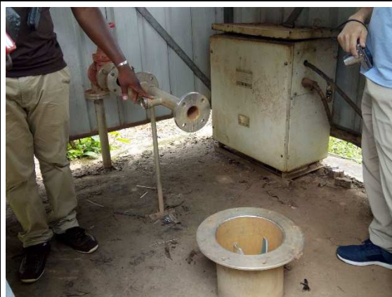
写真-4 : デブレカ市既存深井戸 (井戸内ケーシング破損のため 不使用)
