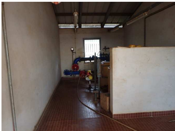
写真-11 塩素消毒設備
