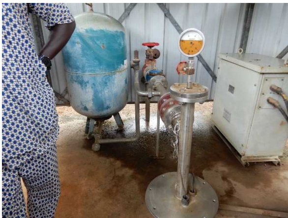
写真-1 深井戸 降圧トランスとエアチャンバーが設置されている
