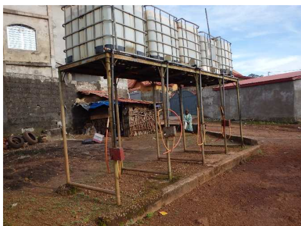
写真-19 デブレカ市ケイタヤ地区に2009年に軍の緊急プログラムで建設された飲料水用深井戸設備。
