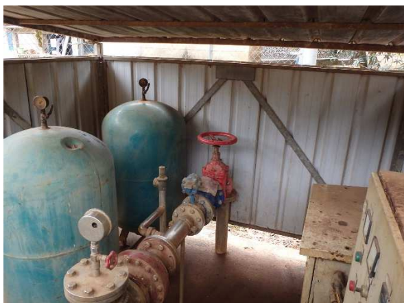
写真-9 現在使用中の深井戸 これとは別に井戸崩壊により休止した井戸もある
