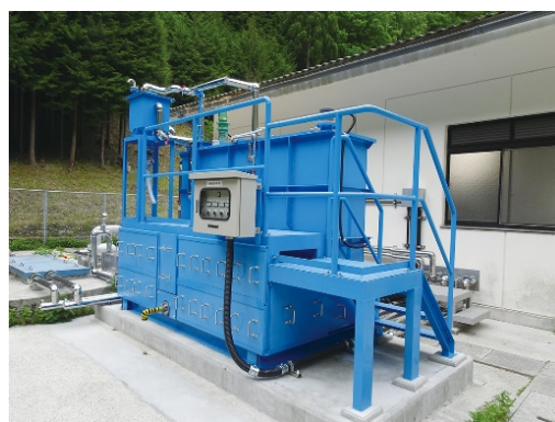
兵庫県佐用町奥海浄水場 MIEX 処理システム
