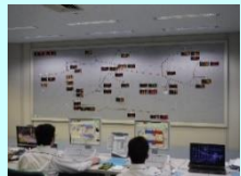
流量・水圧等の監視 (24時間・365日)
