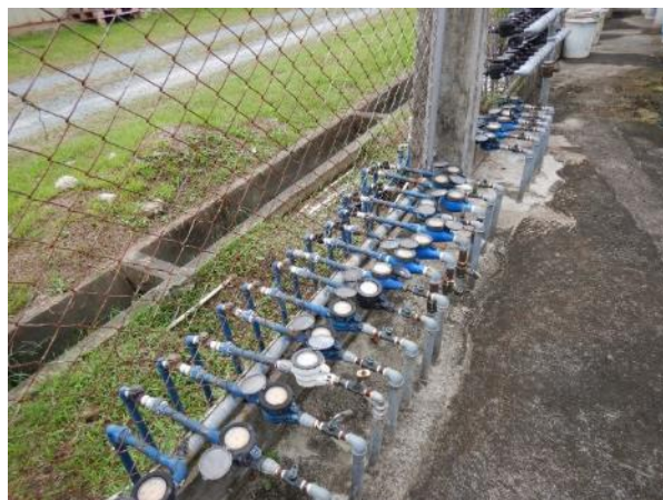
各戸給水のメーター
