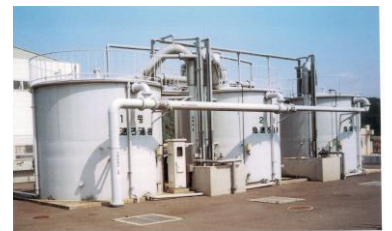
浄水量：5,280m 3 /日
