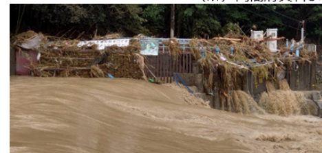
令和4年台風15号による静岡市の取水口の被災状況
