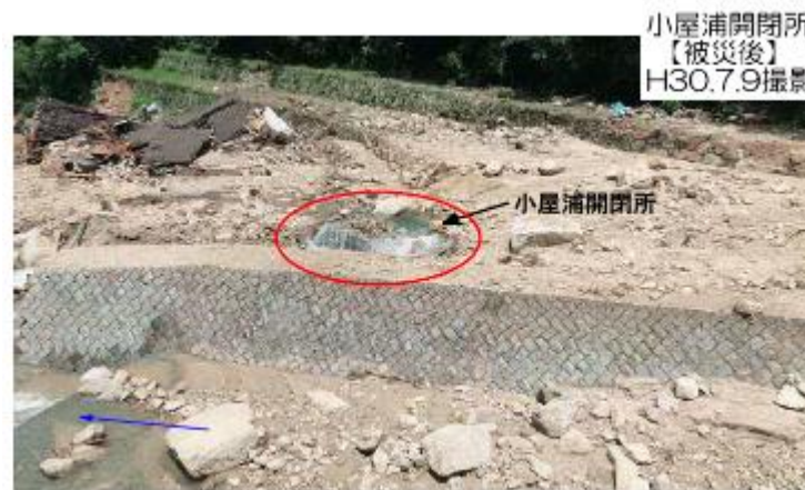
小屋浦開閉所 (被災後)
