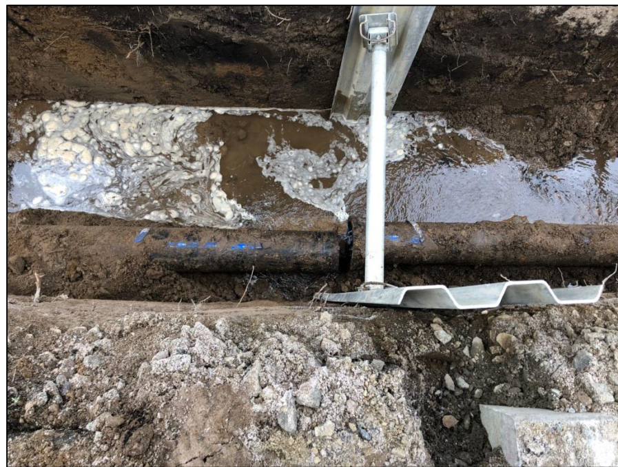
Φ200 T型継手部からの漏水 (配水管)
