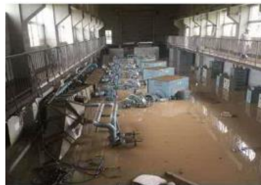
本郷取水場 ポンプ室(水没) H30.7.8 午後0時
