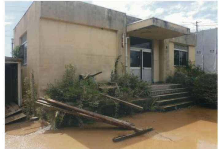
被災後の真備浄水場
