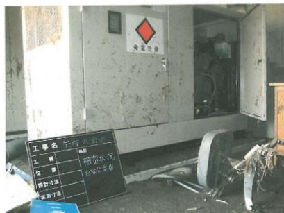
電気・薬品室内部 自家発電設備
