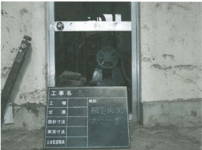
薬品・機械・電気室内部 送水ポンプ設備
