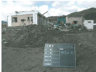
取水井戸ポンプ室(右) 電気室(左)
