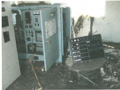
電気・薬品室 自家発電設備(奥) 電気計装設備室(手前)
