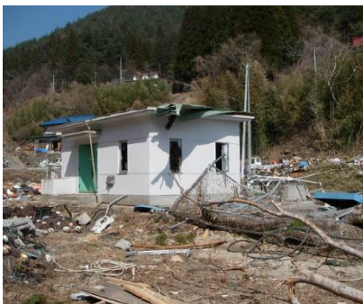
被災状況 (平成 23 年 4 月 1 日)
