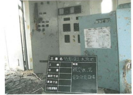
電気・薬品室 自家発電設備(手前) 電気計装設備室(奥)
