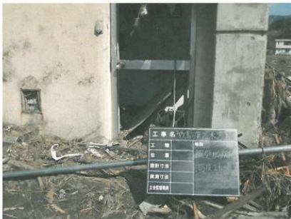
電気・薬品室 濁度計室
