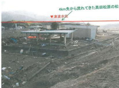
取水井戸ポンプ室(左) 電気室(右) 資材倉庫(中央手前)
