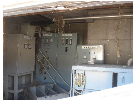
浸水した中継ポンプ場
