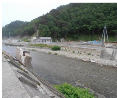
被災状況 津波により落橋 (平成 23 年 3 月 28 日)
