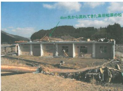
竹駒第1水源地 電気室
