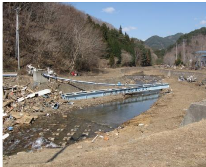
被災状況 津波により落橋 (平成 23 年 4 月 12 日)
