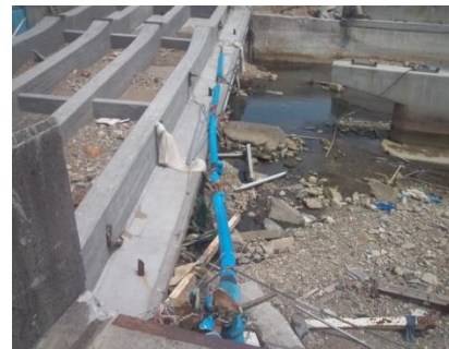
被災状況 津波により落橋 (平成 23 年 5 月 17 日)
