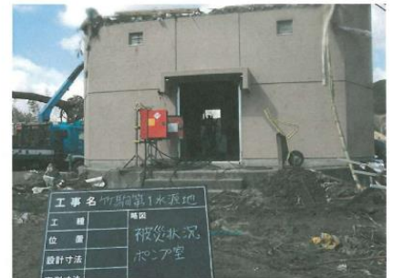
取水井戸ポンプ室
