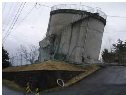
被災状況 (平成 23 年 4 月 7 日)
