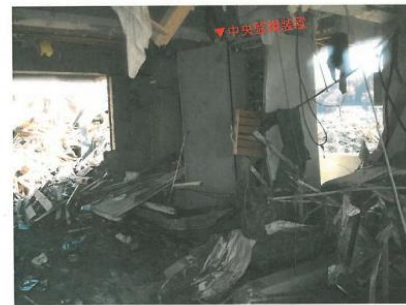
市役所庁舎内部 水道事業所中央監視装置
