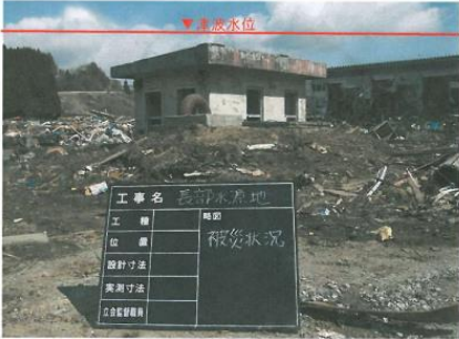
薬品・機械・電気室
