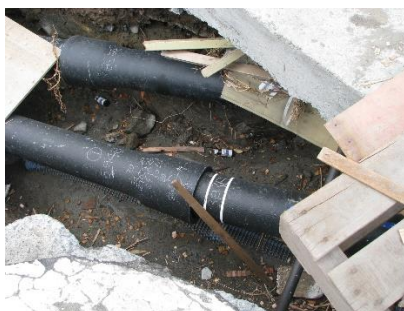
被災状況 (平成 23 年 3 月 15 日)
