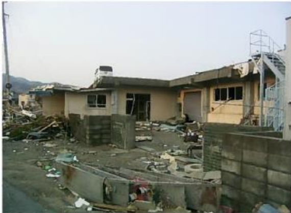
被災直後の写真 (外観)
