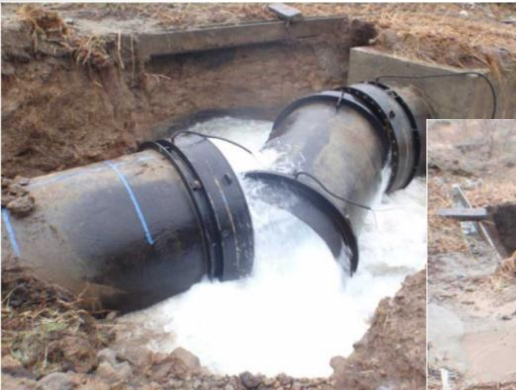
継手の拔出しによる漏水 (SPφ2400送水管)
