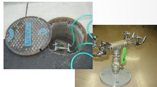
【地下式給水栓】
