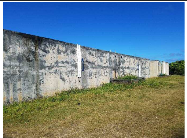
写真-6:既設配水池(ババウ島) 容量約1,400m 3 (450m 3 ×2、500m 3 ×1)の鉄筋コンクリート造。老朽化により部分的に壁面漏水がある。
