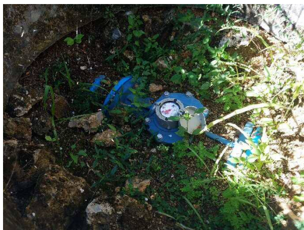
写真-9:主要配水流量計
