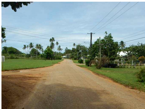
写真-15: ババウ島の道路状況
