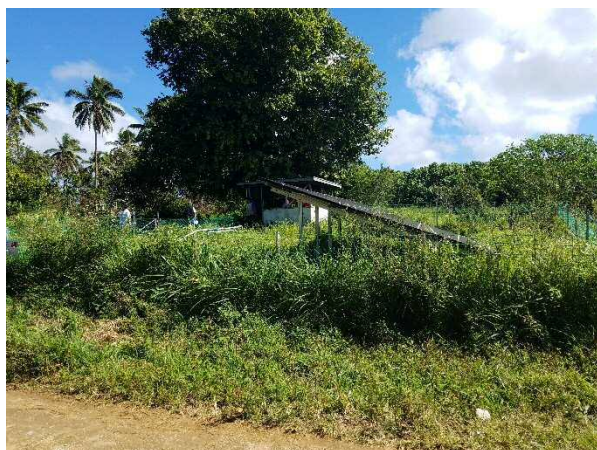
写真-17: 日本の援助で設置された太陽光発電とポンプ設備
