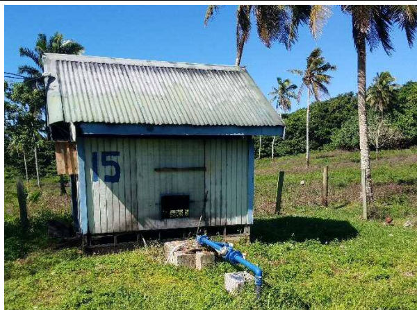
写真-11:取水井戸の状況
