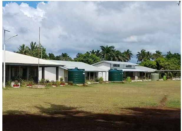
写真 2.5 学校に設置された雨水集水設備
