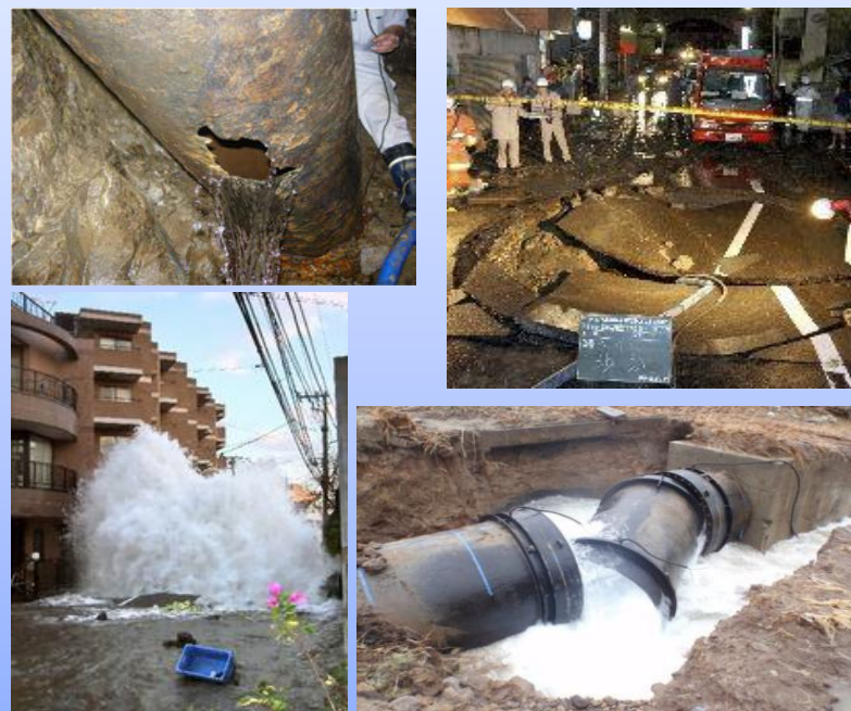
老朽化による事故の例
