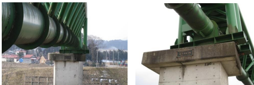
支承部の損傷によるずれ
