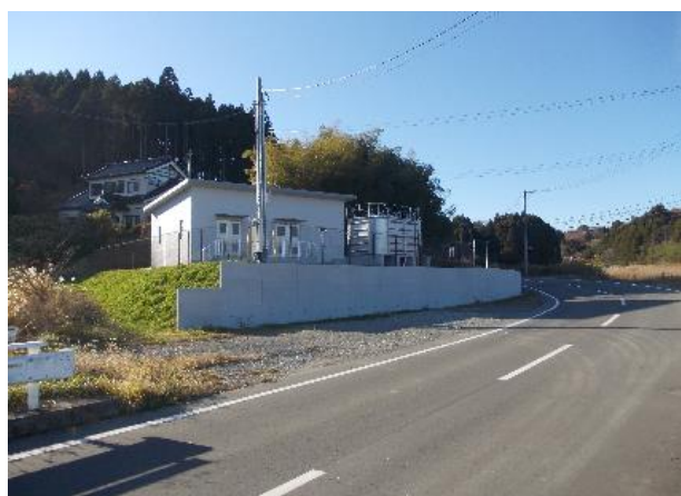
ポンプ場（復旧後） 想定浸水深(5m～6m)を考慮した高さに移設
