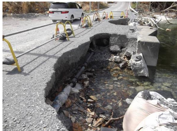
水道配水本管 露出状況
