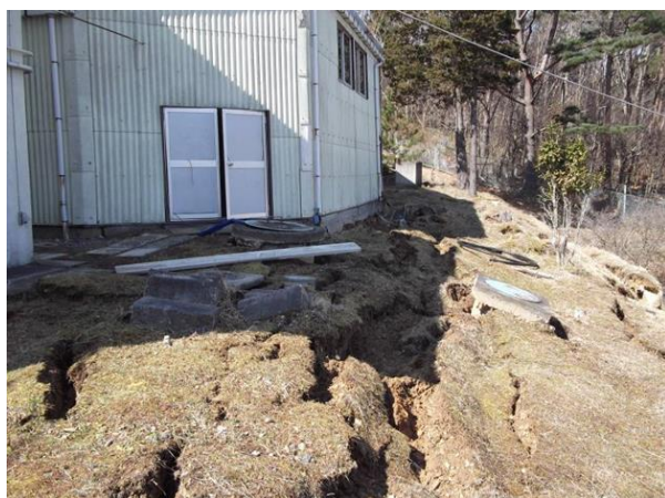
鷲神浄水場 外構 間地ブロックの崩壊 ろ過池上層の傾斜・沈下
