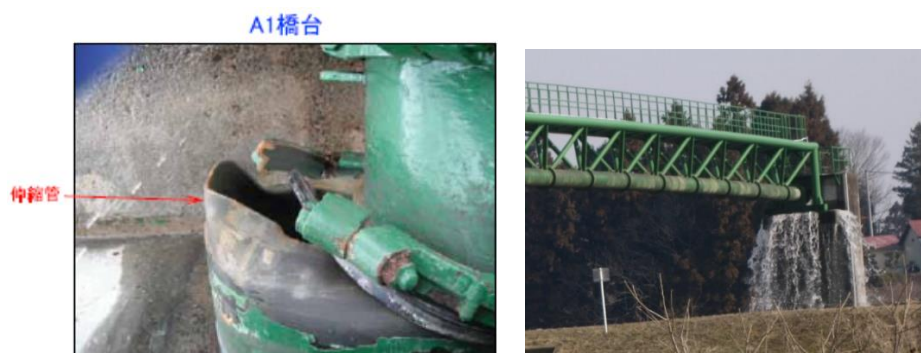
伸縮管の破断による漏水
