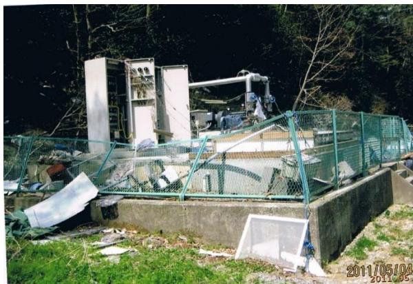
出島送水ポンプ場 津波により全壊流出
