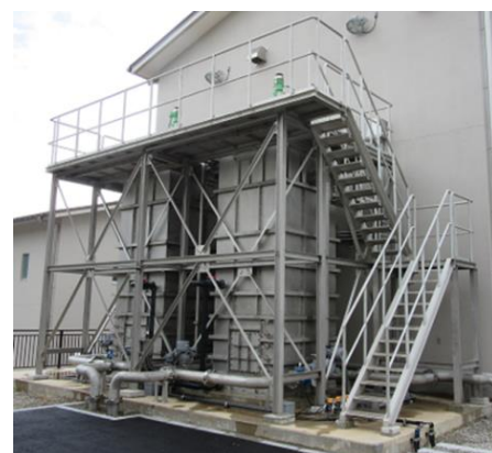
東京都小笠原村扇浦浄水場 MIEX 処理システム
