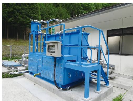
兵庫県佐用町奥海浄水場 MIEX 処理システム
