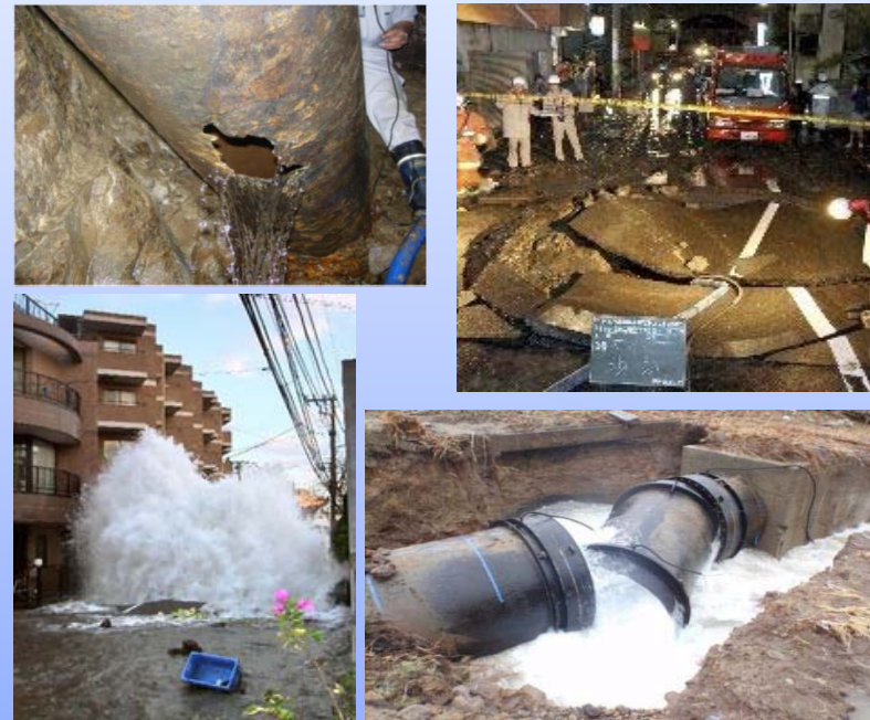
老朽化による事故の例
