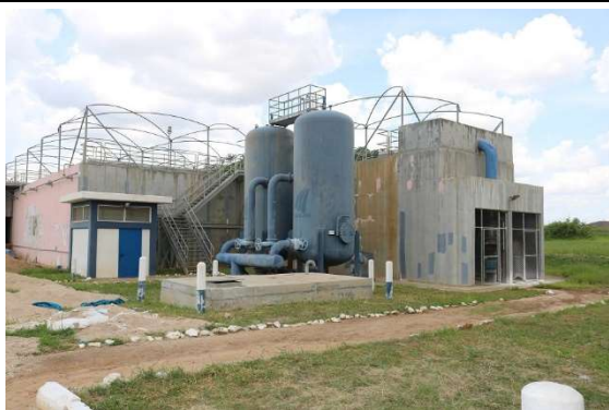
ナンプラダムの浄水場
