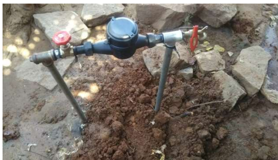
ナンブラ市内に設置された各戸接続事例
