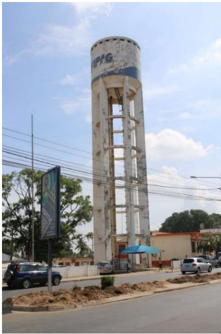
第3 ポンプ場内にある高架タンク
