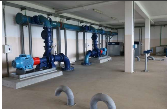
第 1 ポンプ場内部
