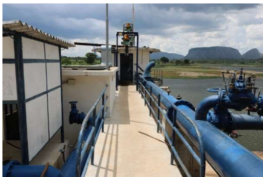
ナプラダムに設置された取水施設
