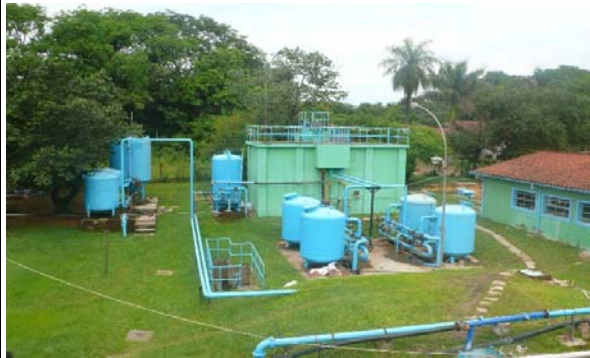
No.1 ビジャ・アジェスESSAP浄水場
