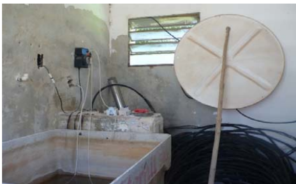
No.11 塩素注入設備 塩素注入設備はあるものの使用されておらず、民間を除くすべての井戸で大腸菌群が測定されている。
