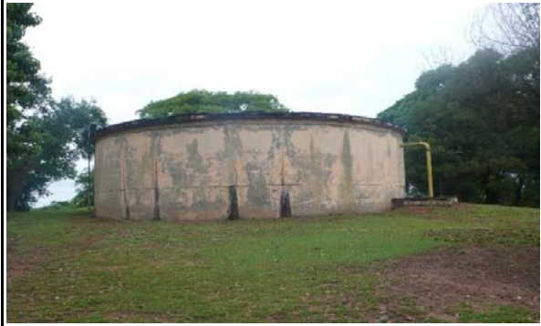
No.2 ビジャ・アジェス配水池
