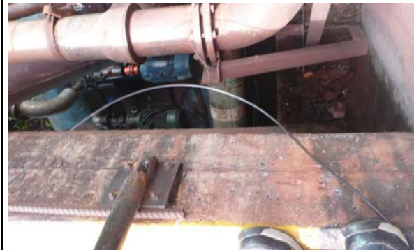
No.4 取水ポンプ(ACEPAR敷地内)
