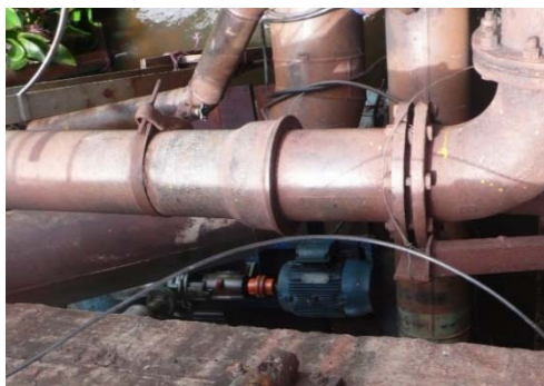
写真-1 棧橋の下に設置された取水ポンプ
