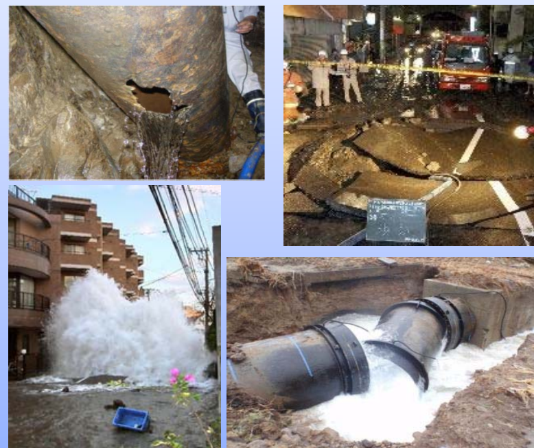
老朽化による事故の例
