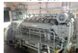
例：自家発電機の整備
