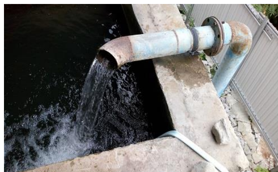
着水井で凝集剤添加している
