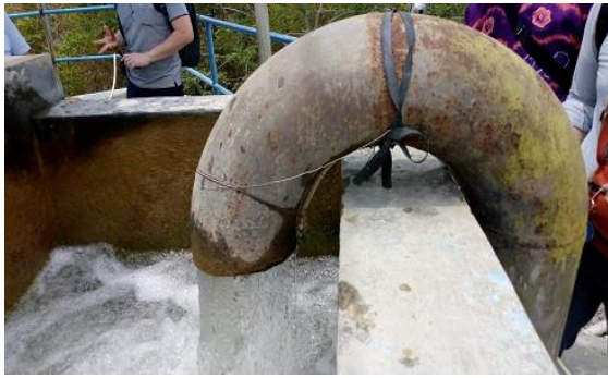
着水井では凝集剤が添加されている
