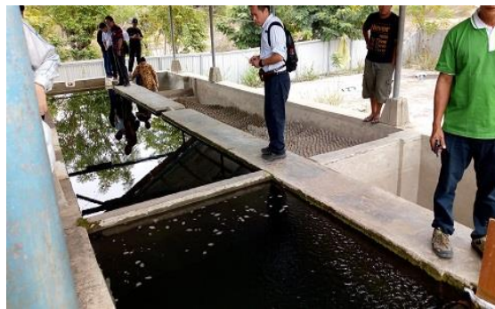
沈殿槽にハニカムチューブが設置されている
