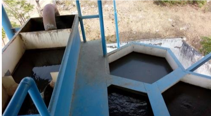
着水井から凝集槽〈ハの字型〉
