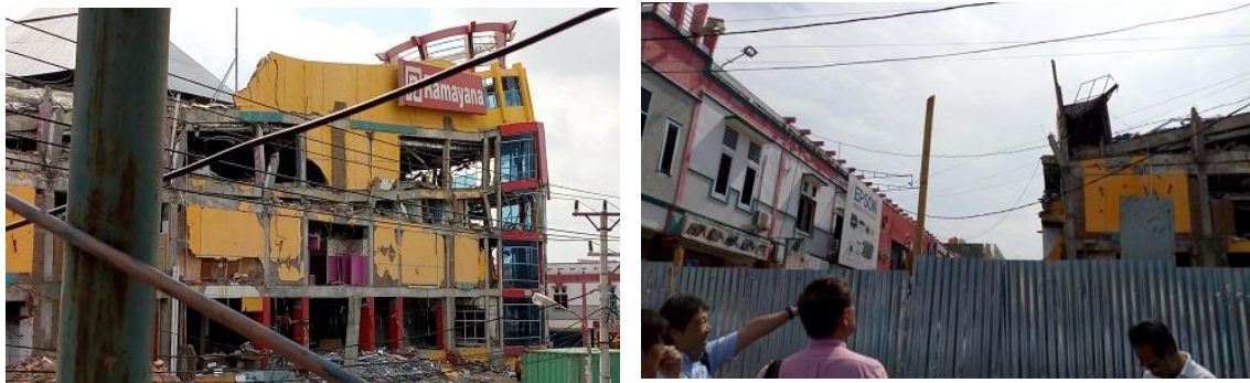
図 6.13 市内で損壊したモールの様子(写真) 元々設計施工に構造上の問題があった可能性がある
