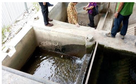
ろ過槽の砂層が散逸しフロックがそのまま配水されている
