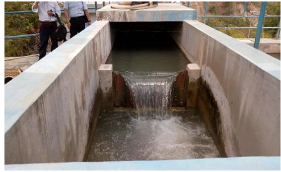
急速混合後の三角堰
