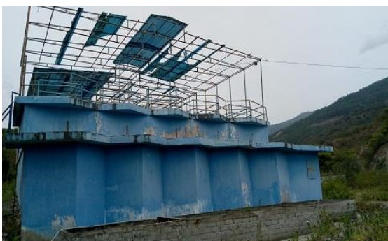
公共事業国民住宅省の凝集沈殿ろ過処理施設
