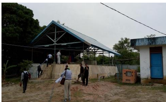
KAWATUNA 浄水場全景
