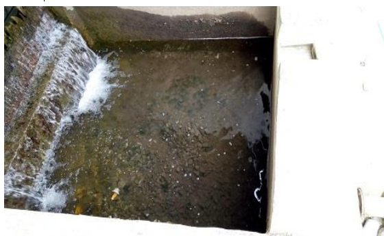
集水装置が破損している
