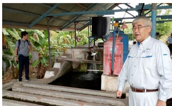
着水井からフロック形成槽
