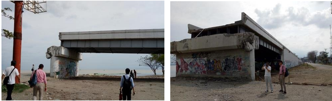
破壊された橋
