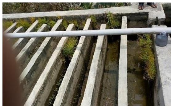
ブロック形成槽には堆積物が溜まっている
