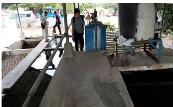
凝集剤タンク
