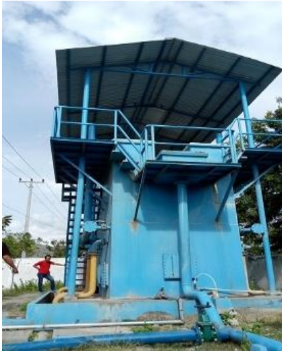
鋼板製ユニット型凝集沈殿ろ過処理施設
