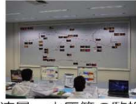
流量・水圧等の監視 (24時間・365日)
