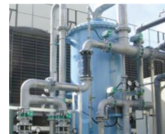
急速ろ過器 除鉄除マンガンろ過器
