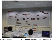
流量・水圧等の監視 (24時間・365日)
