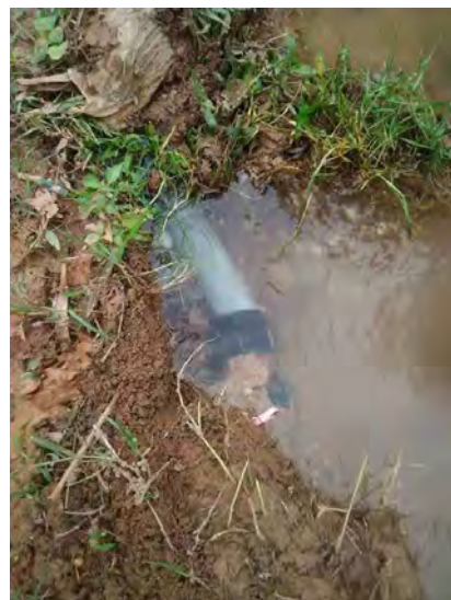
漏水状況 (NPNL 提供写真)
