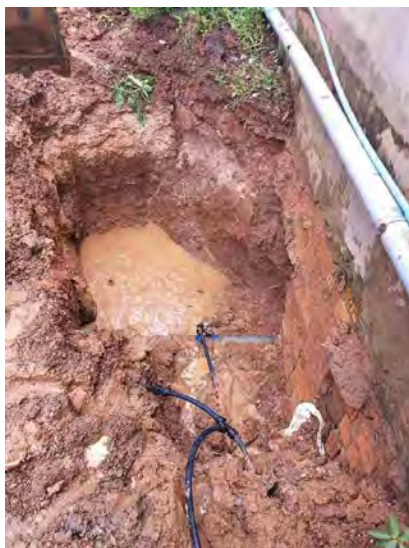
漏水状況 (NPNL 提供写真)
