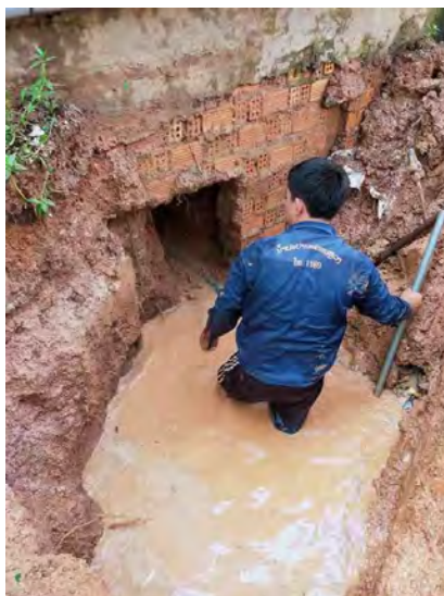
漏水状況 (NPNL 提供写真)
