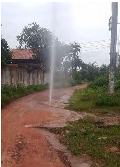
漏水状況 (NPNL 提供写真)
