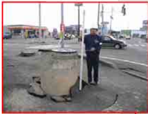
小千谷市公共下水道 マンホール浮き上がり
