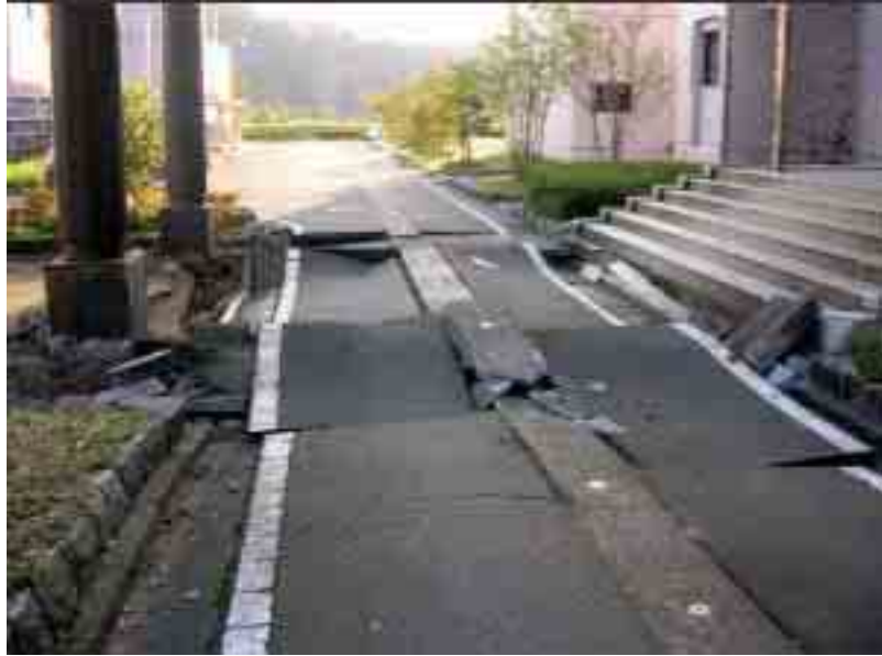
写真 - 3 管理棟玄関前路面異常
