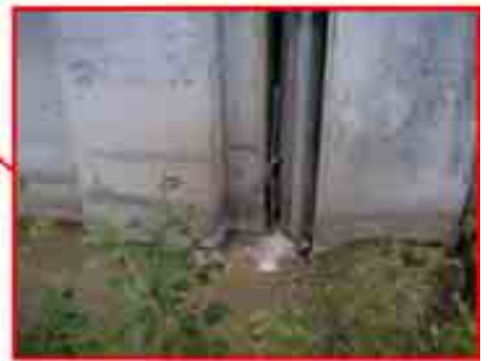
魚野川流域下水道掘之内処理場 水処理構造物クラック被害発生
