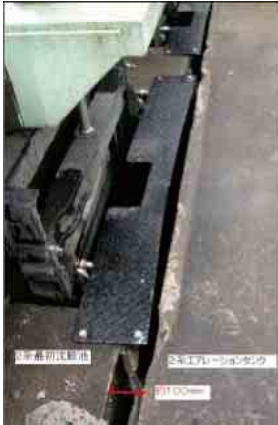
写真 - 5 エアレーションタンク流入ゲート部におけるクラック
