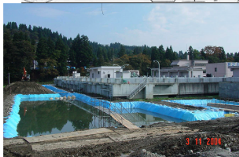
仮設沈殿池(手前)・仮設塩素混和池(右)
