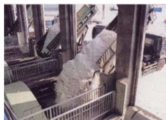
調整池等を活用した融雪槽への積雪
