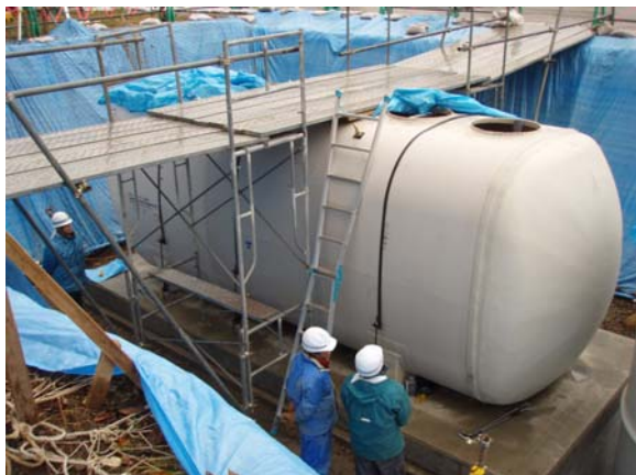
設置状況 接触酸化槽
