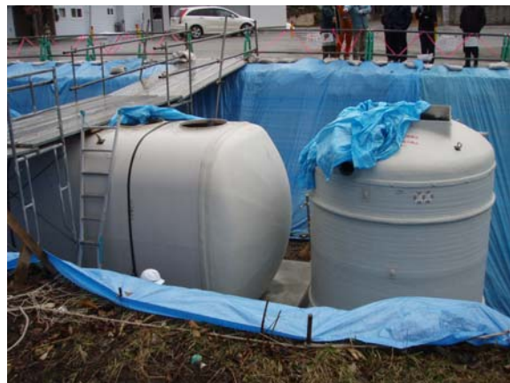
設置状況 原水ポンプ槽
