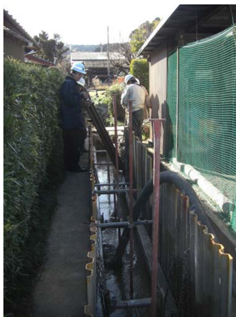
写真－1 狭小道路
