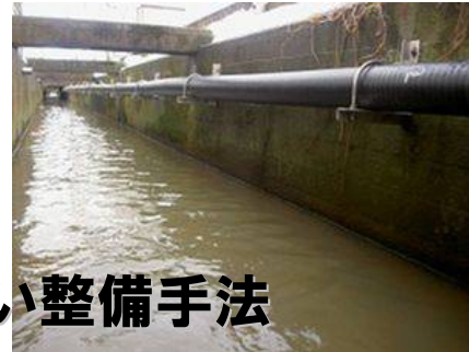
クイック配管(露出配管)
