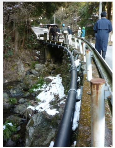
クイック配管(露出配管) (檜原村)
