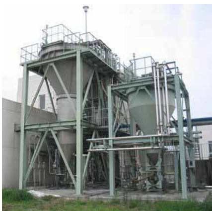
島根県宍道湖東部浄化センター
