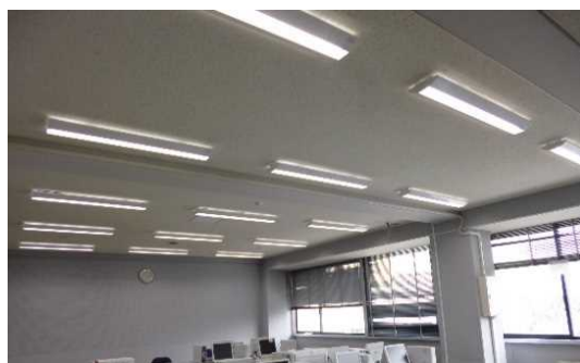
写真2 LED照明器具
