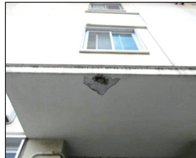
玄関底の剥離
