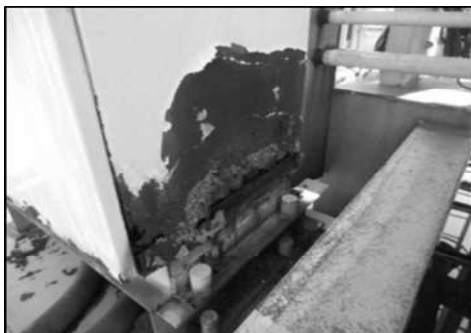
屋外制御盤のさび
