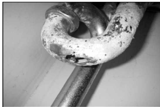
排水トラップの腐食
