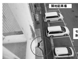
屋外階段手すり部の異常
