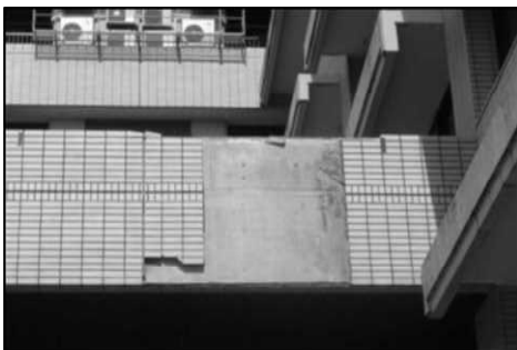
外壁タイルの落下
