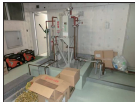
オイルタンク廻りに置かれた物品
