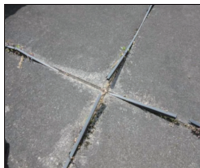
防水目地の劣化
