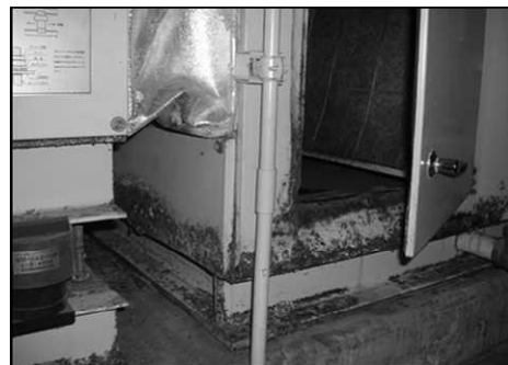
ユニット形空調機の腐食
