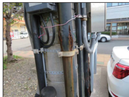
電気配管の腐食
