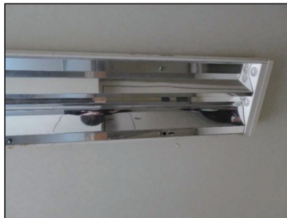
蛍光管が外された非常用照明器具
