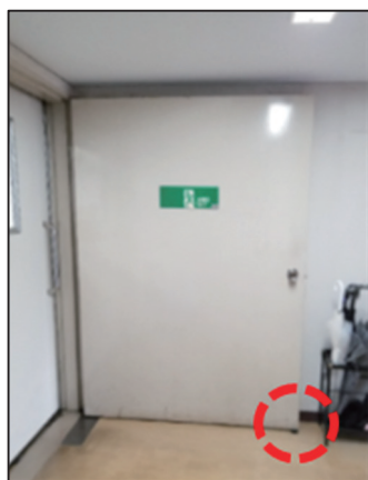
常時解放された防火扉
