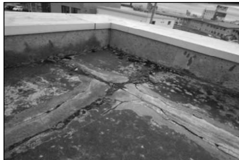
防水押さえコンクリートの損傷
