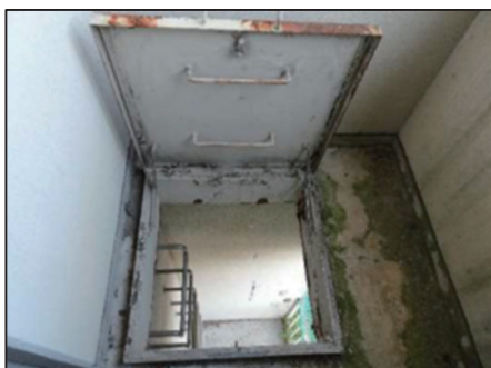
避難はしごの蓋の錆び
