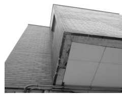
外壁タイルの異常
