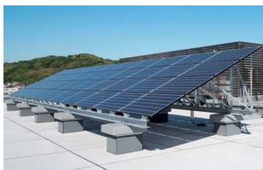
写真3 太陽光発電設備
