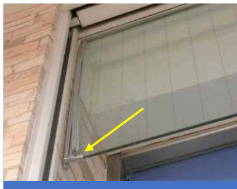
防煙垂れ壁の破損
