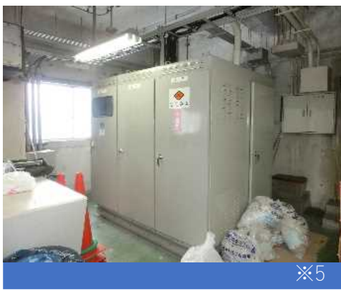
電気室の障害物 (可燃物)
