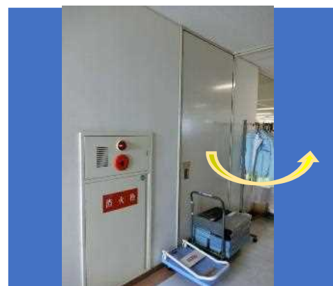
防火扉前の障害物 (矢印方向に開かなくてはならない)
