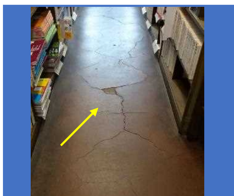
床のひびわれ
