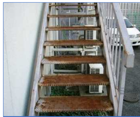
屋外階段の腐食
