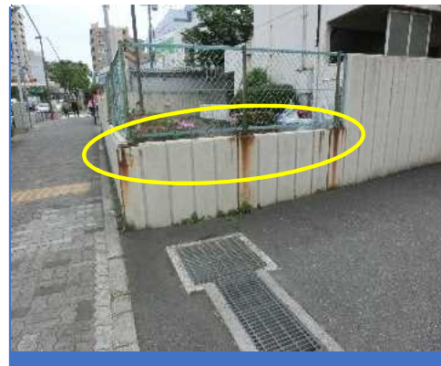
金属フェンス根本の腐食
