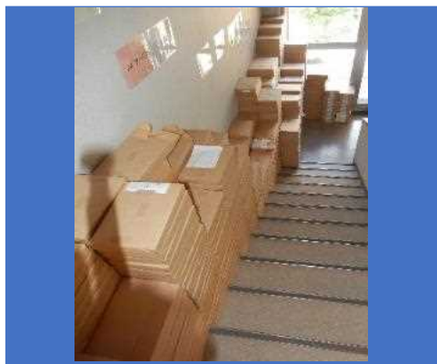
階段室の障害物
