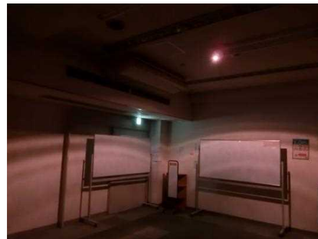
誘導灯＋非常用照明を点灯
