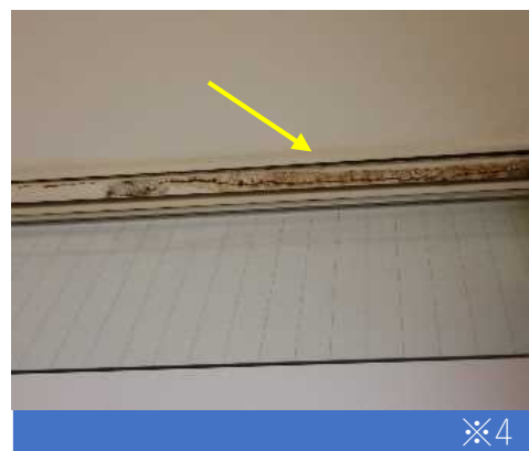
防火シャッターの腐食
