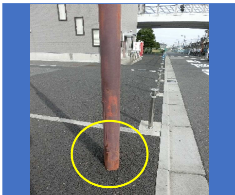
外灯ポール支柱の腐食
