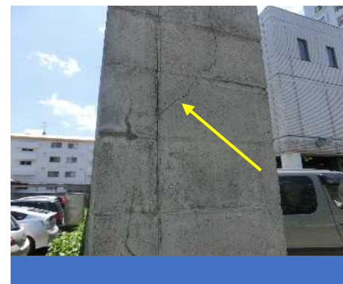
ブロック塀の亀裂
