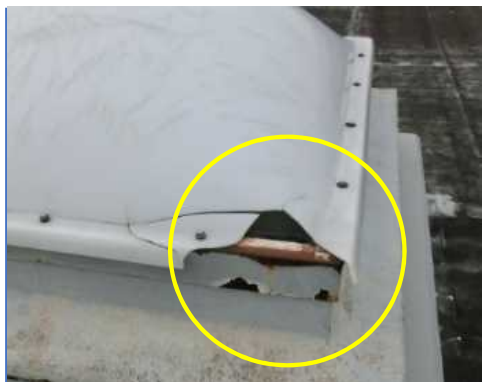
屋上トップライトの破損
