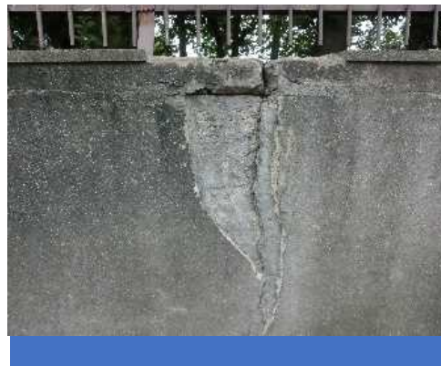
コンクリート塀の損傷
