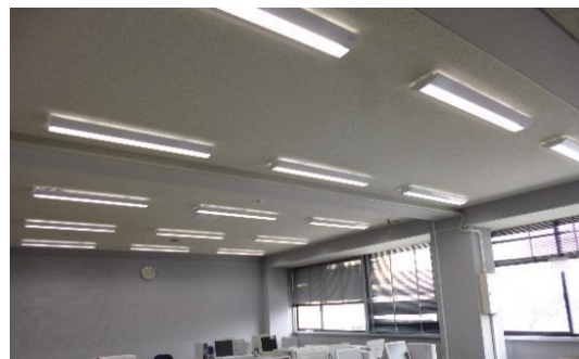
写真2 LED照明器具
