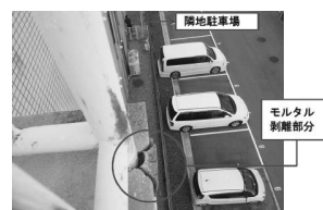
屋外階段手すり部の異常
