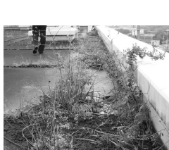
屋上目地部の雑草
