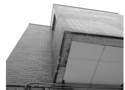
外壁タイルの異常
