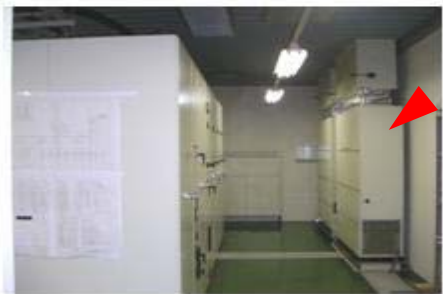
電気室冷却用パッケージ空調機
