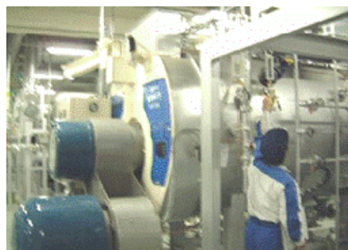
冷凍機の定期点検
