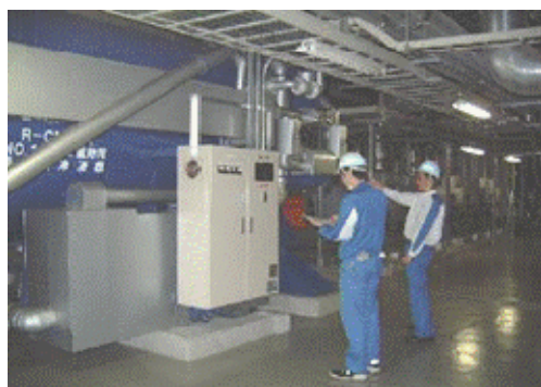
ボイラーの定期点検
