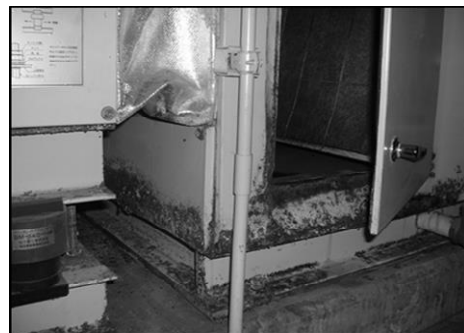
ユニット形空調機の腐食
