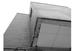
外壁タイルの異常
