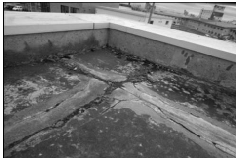
防水押さえコンクリートの損傷
