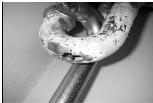
排水トラップの腐食
