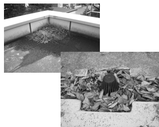
ルーフトレンの清掃不良
