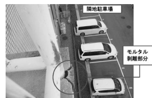
屋外階段手すり部の異常
