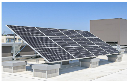
写真3 太陽光発電設備
