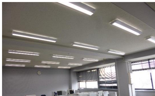
写真2 LED照明器具
