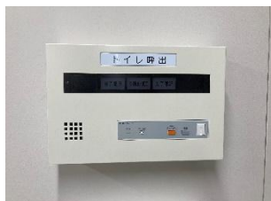
トイレ呼出表示装置
