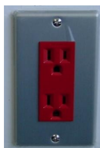
発電機回路コンセント
