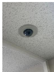
監視カメラ (屋内)
