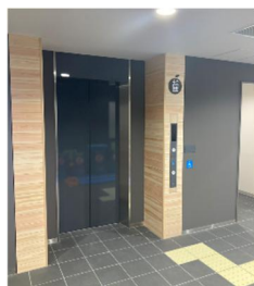
エレベーター
