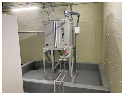
燃料小出タンク
