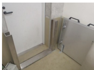
パネル式水防設備
