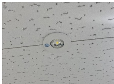
非常用照明の点検
