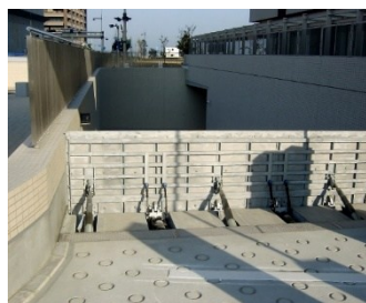
電動式水防設備（作動時）
