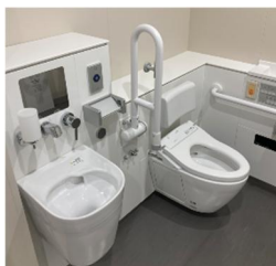
オストメイト用設備+大便器
