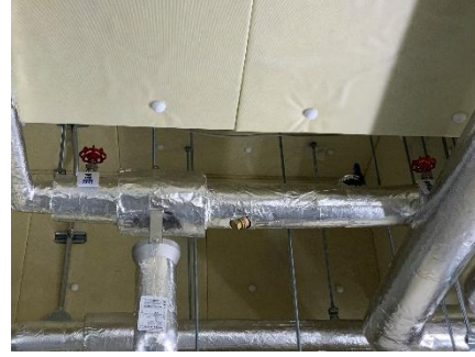
空調補給水・加湿用給水管元バルブ (減圧式逆流防止弁)
