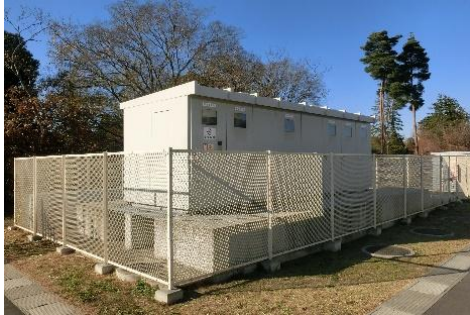
屋外キュービクル
