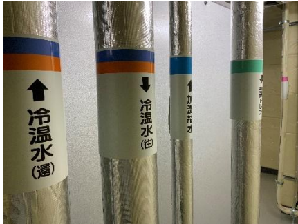
配管識別表示
