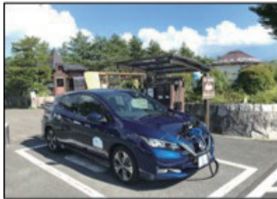
道の駅でのEV充電器の設置 資料) 国土交通省
