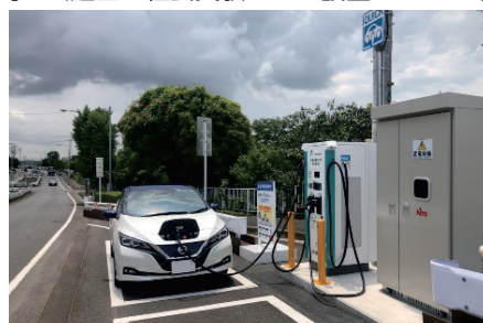
横浜市内の公道上に社会実験として設置されたEV充電施設
