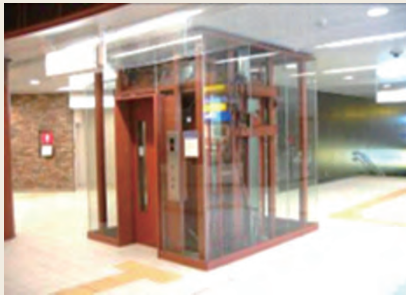
段差の解消（エレベーター）
