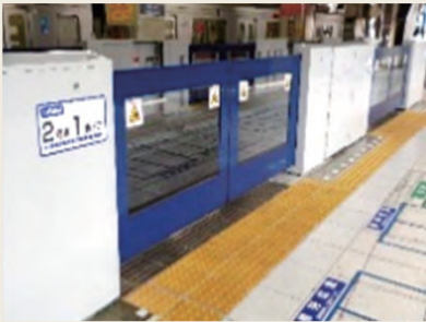
ホームからの転落防止対策（ホームドア）
